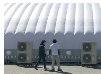
床置型エアコン 室外機
